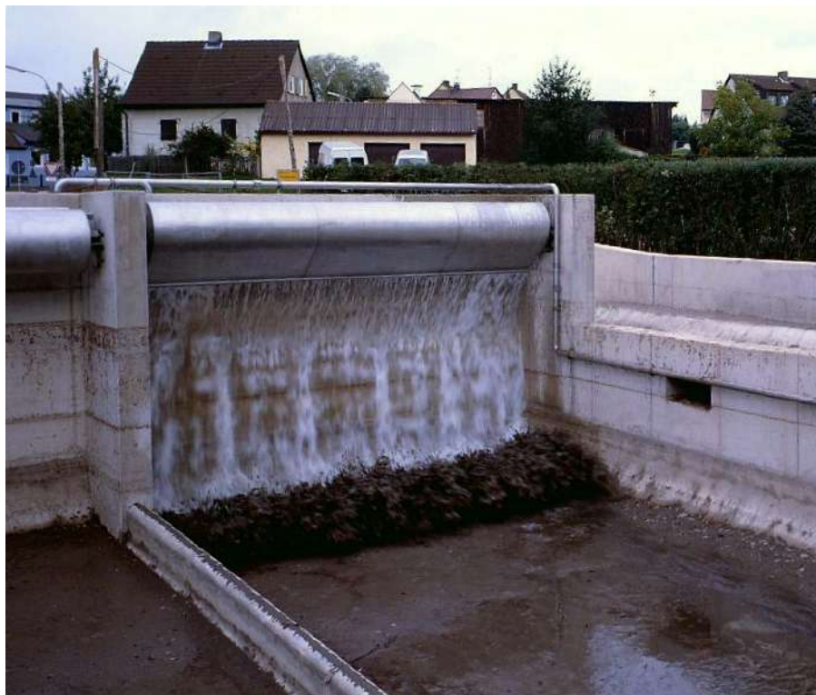
Fig. 5: Sistema di lavaggio vasche FluidFlush installato su vasca di pioggia
